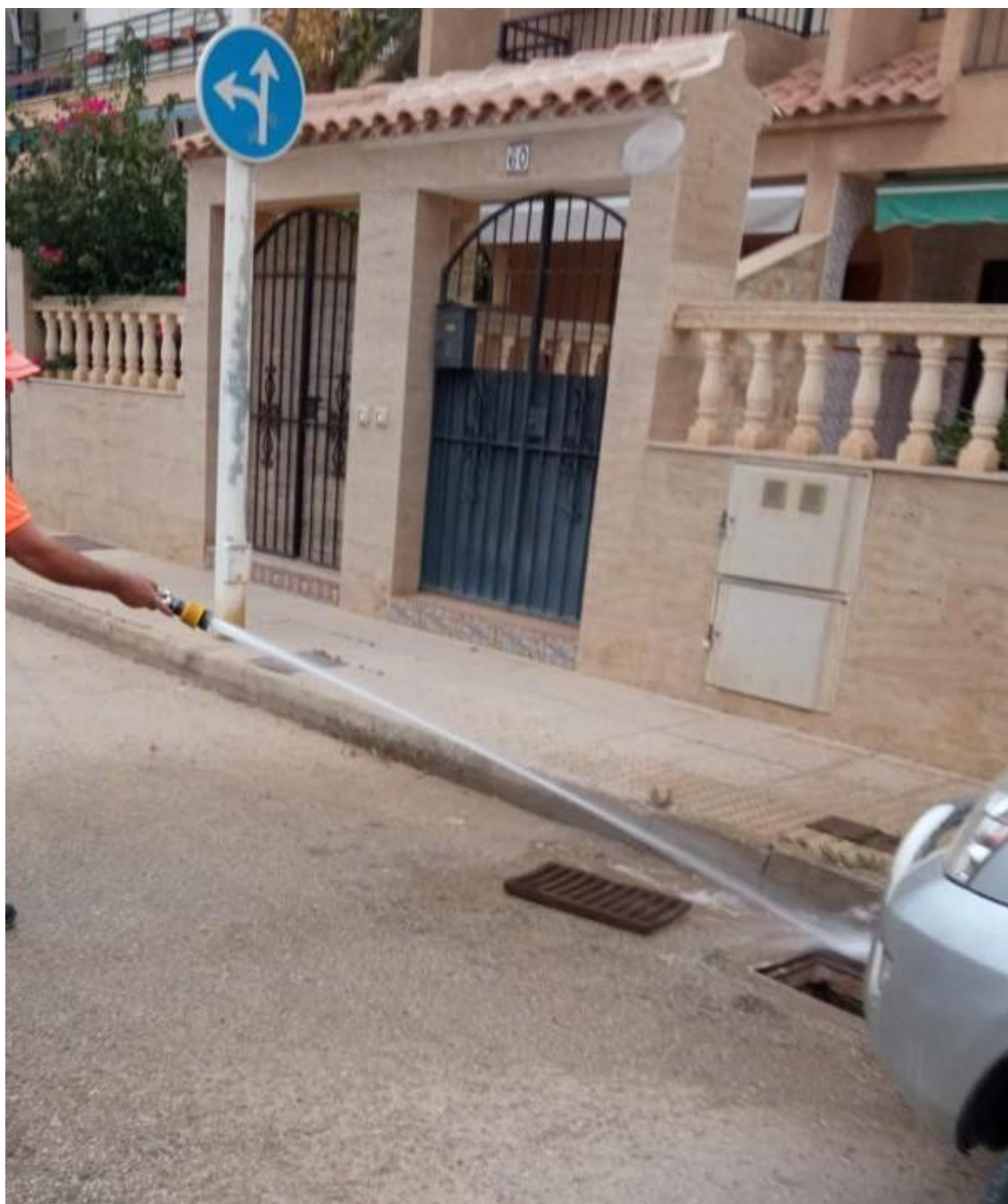
Limpieza de imbornales
